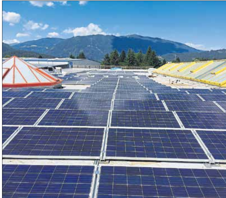
Ungenutzte Flächen lassen sich mit Photovoltaikmodulen bestücken. [Beigestellt]
